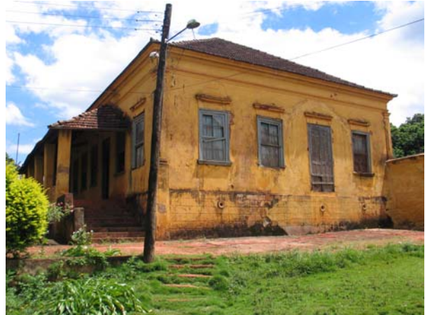
Figura 394 - Antiga fachada do casarão da fazenda São Lourenço, Jaú. Pode-se ver a antiga porta de entrada e as marcas do alpendre e da escadaria, que foram suprimidos. Foto: V. Benincasa.
