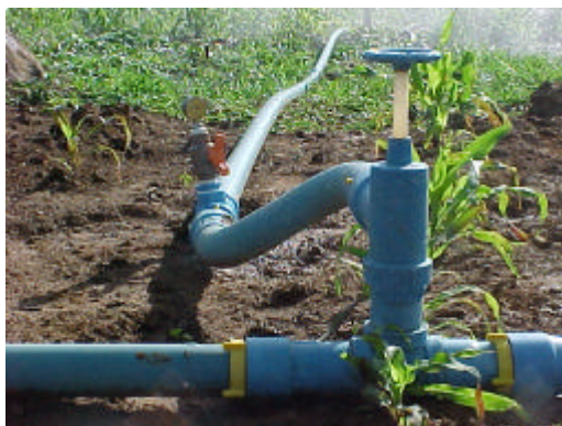
Figura 15 - Detalhe da instalação de manômetro para controle na pressão de saída de linhas laterais de aspersão convencional.
